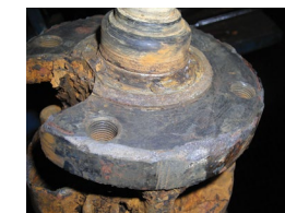
Daño de corrosión de campana superior
