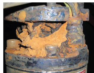
Daños por corrosión Consulte la siguiente página
