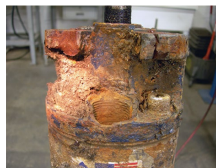
Sin in cable-conector - Sedimentos No aplica garantía
