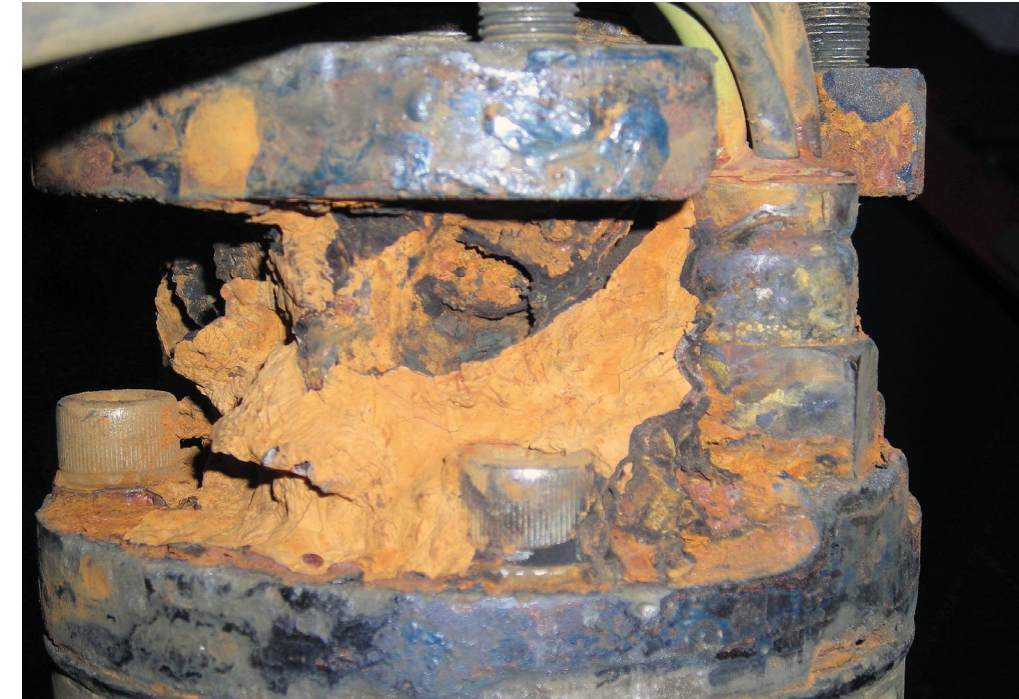
El entorno agresivo provoca corrosión
