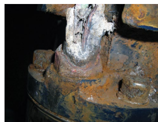
Corrosión Excesiva No aplica garantía
