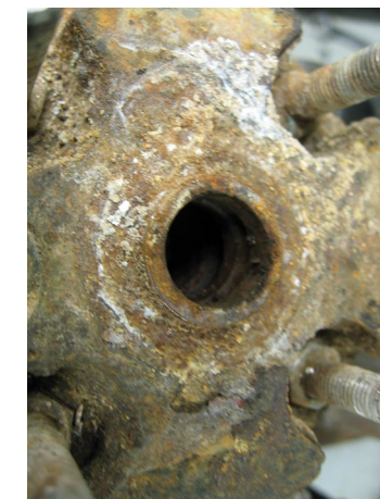
Exceso de corrosión/incrustaciones
