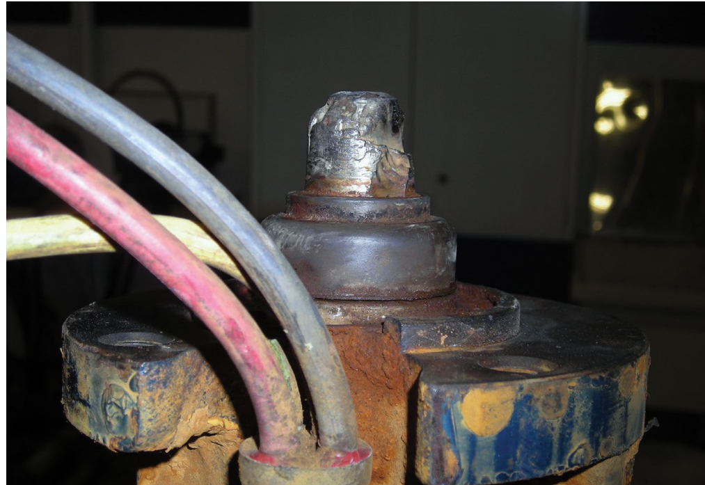
Eje roto por torsión excesiva (Ej.: bomba que gira hacia atrás durante el arranque de la bomba)
