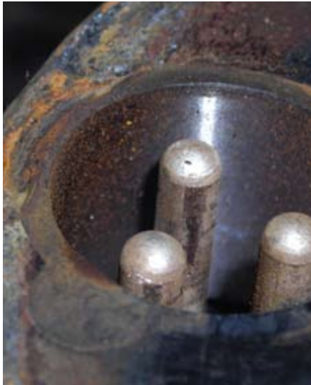
Corrosión y óxido en entrada del conector
