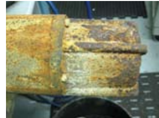
Corrosión/sarro No cubierto por garantía
