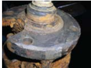
Daño por corrosión en campana
