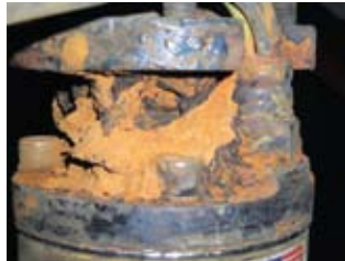
Daño por corrosión Consulte la página siguiente
