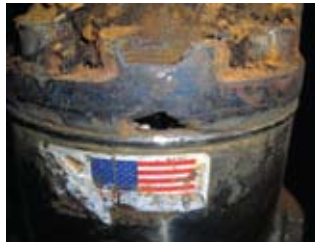
Corrosión en área de conector
