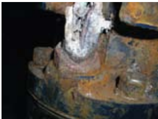
Corrosión excesiva No cubierto por garantía
